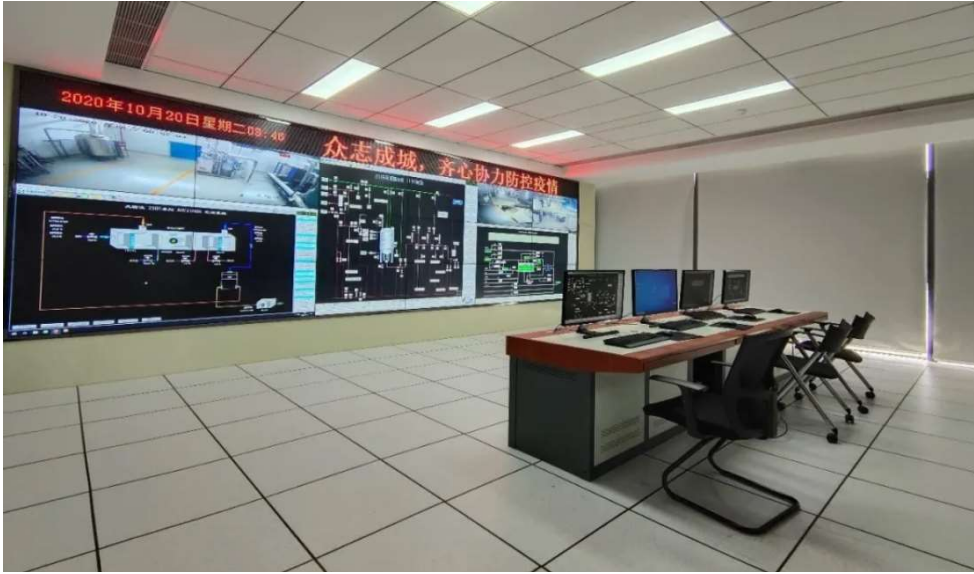
图 生产控制室
