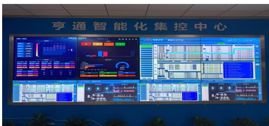
图 7-11 亨通光电智能化集控中心
