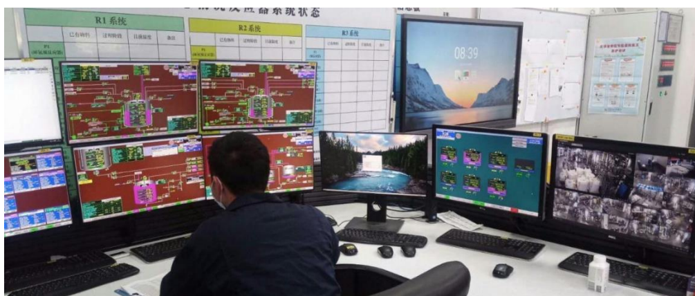
图 7-6 PPG 涂料生产中央控制室
