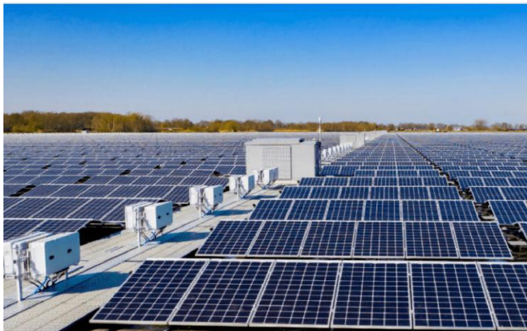
某晶硅光伏企业屋顶太阳能综合利用
